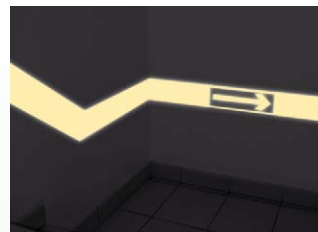
Naścienny ciąg ewakuacyjny SYSTEMU TD®. Widok po zaniku światła.
